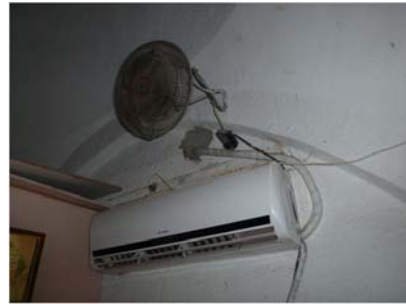
شكل 22: استخدام وحدات كهربائية خارجية في مسجد محمد المغربي
